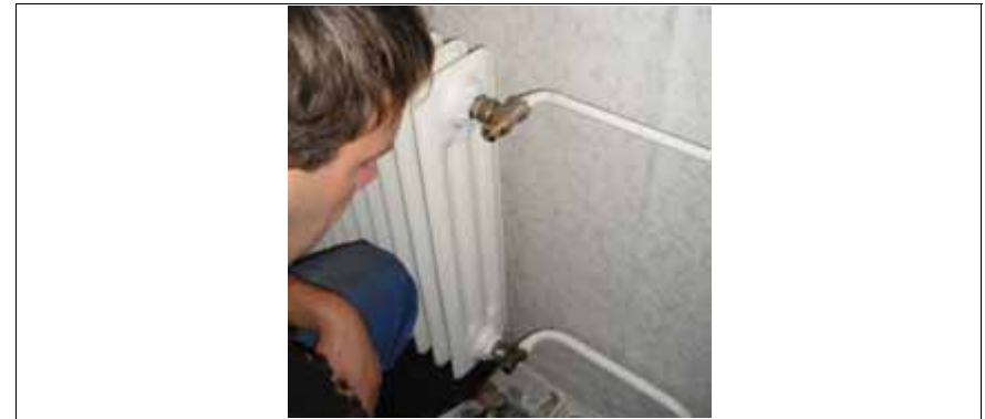
Abbildung 9 (N15) Das neue voreinstellbare Thermostatventil ist jetzt installiert
