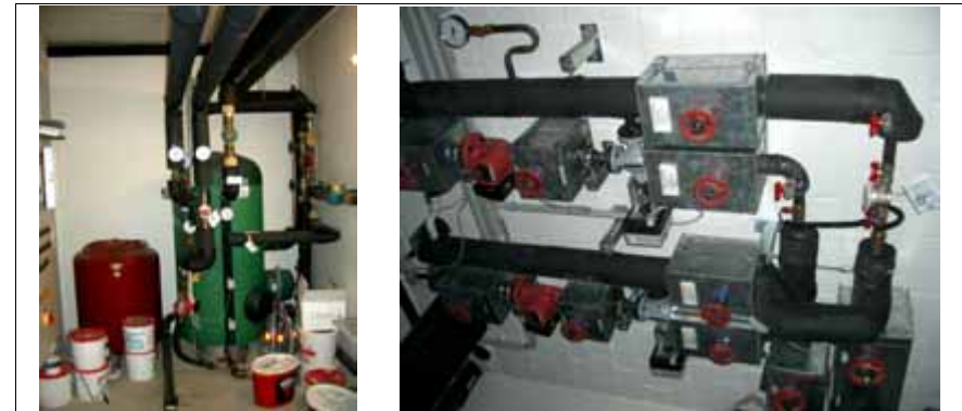
Abbildung 2 (N40, N41) Fotos von zwei aufgenommenen Heizungskellern
